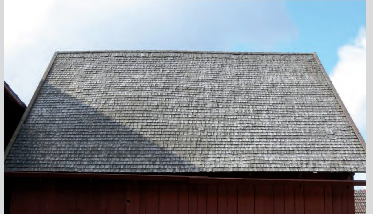
Figur 3.17. Taket före omläggning. Lägga märke till att taket har lappats mitt på taket.
