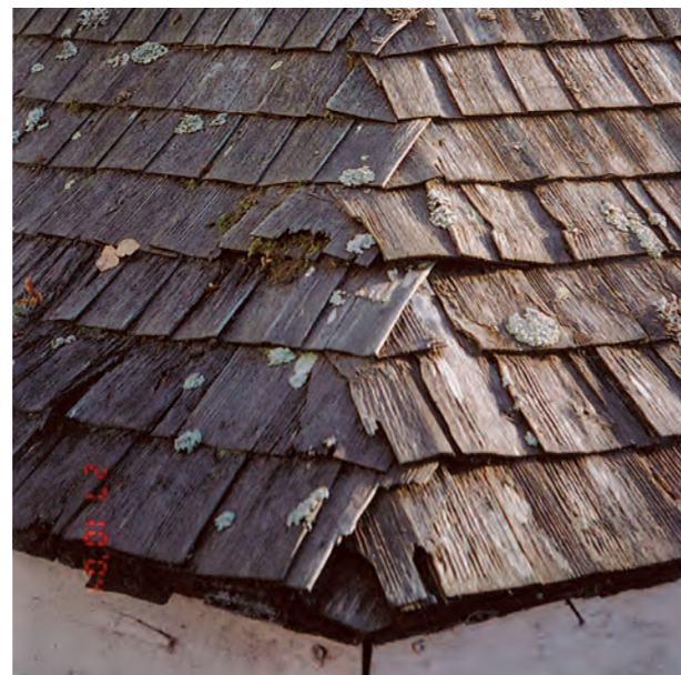
Figur 3.12. Här täcks snednocken genom att spånskiften fortsätter över nocken. Spån på de båda takfallen ligger omlott.
